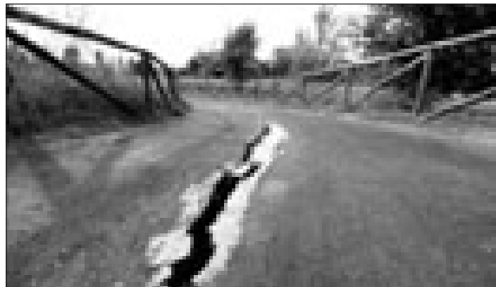
Le immagini mostrano il degrado di uno dei ponti dell'Oasi (foto Enrico de Divitiis)
