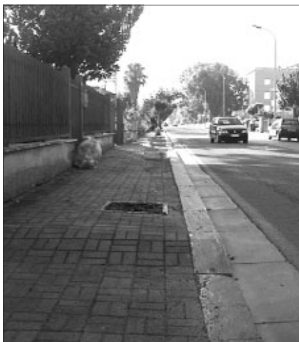
Lo stato in cui versano i marciapiedi in Via Pantanaccio
